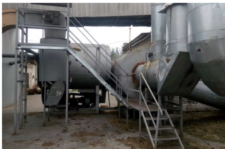
Рисунок 3 – Участок генерации тепла на отходах зерна ООО «Заводоуковский маслозавод», Тюменская область
