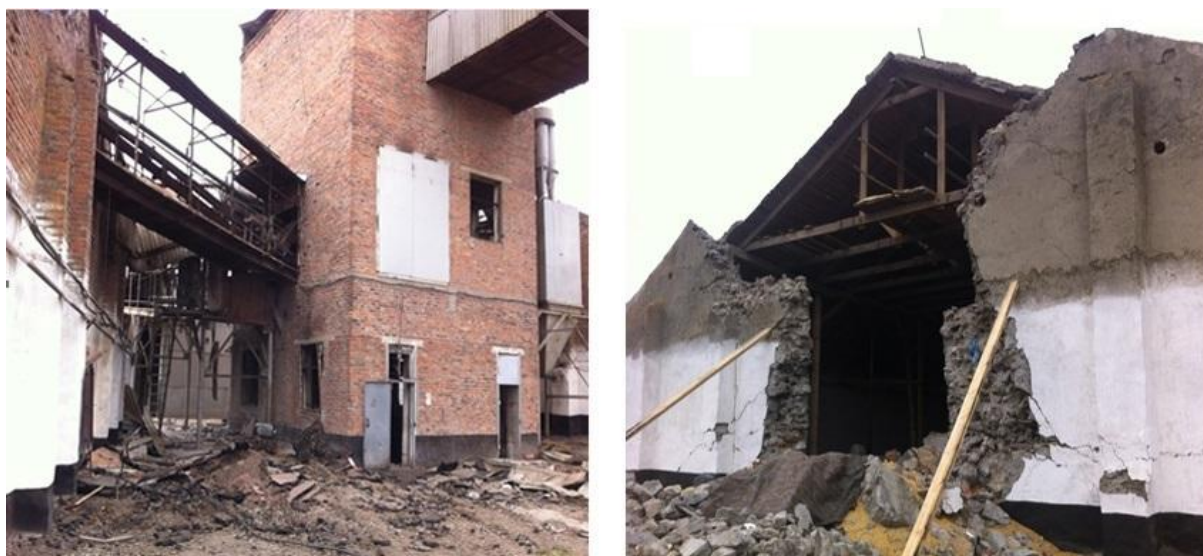
Рисунок 2 – Взрыв пылевоздушной смеси в складе напольного хранения (2014 г.)
