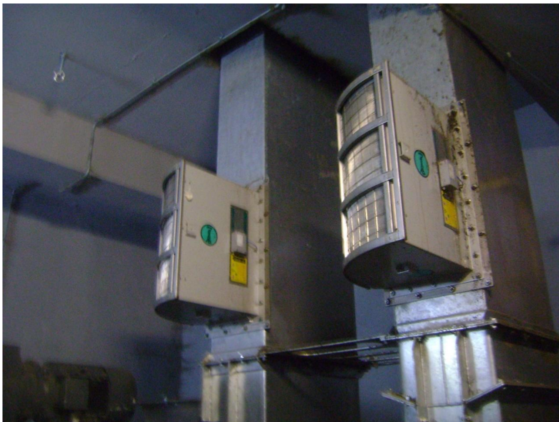
Рисунок 7 – Система Q-Box, смонтированная на норийных трубах. Изготовитель: фирма «REMBE® GmbH Safety + Control» (Германия)
