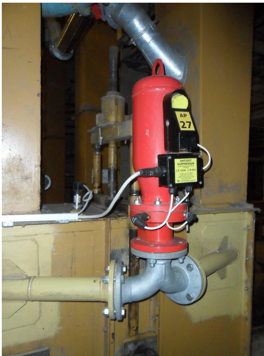
Рисунок 8 – Система подавления взрыва, смонтированная на башмаке нории. Изготовитель: фирма «VST Engineering, spol. s.r.o.» (Чехия)
