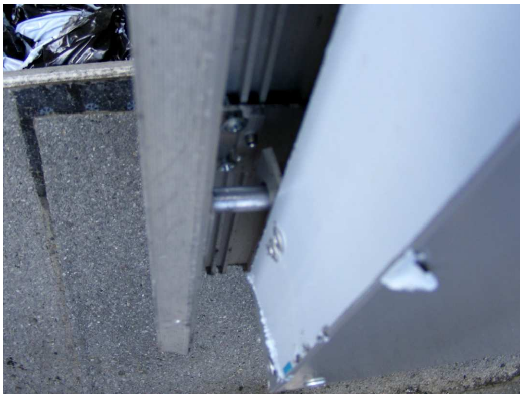
Рисунок 7–Узел крепления кассеты к направляющей посредством салазки со штифтом после ремонта. Крепежный винт салазки выкрутился от вибрации. Салазка прикреплена к направляющей двумя дополнительными саморезами
